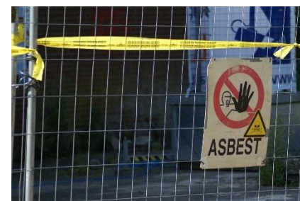
Foto: Hek met gevarenbord ‘Asbest’
